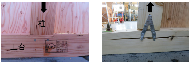
(A)圧縮力が加わる場合 (B)引張力が加わる場合 図4 柱と土台の接合部
