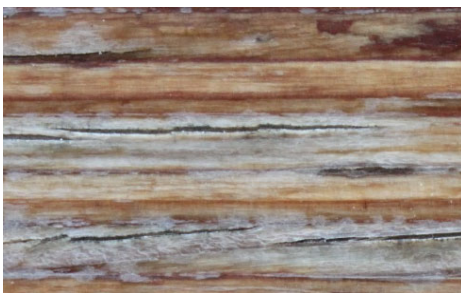
図2 単板の裏割れに起因する塗膜劣化
