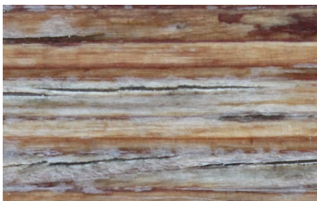
図2 単板の裏割れに起因する塗膜劣化
