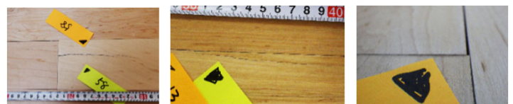
図4 フローリングの押し合いや変形
