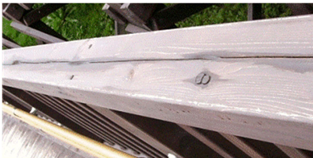
写真7 手すりの干割れ
