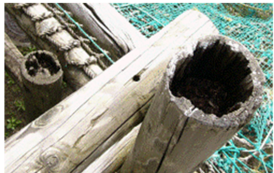
写真5 柱頭部の劣化（腐朽）
