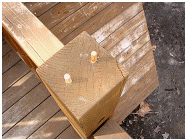
写真16 木口面の状態
