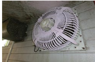
写真1 工場内で孢子が付着した換気扇
