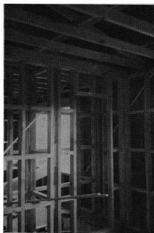
写真-9 低コスト住宅の壁枠組み及び小屋組み 壁は100×50mm枠組材によるもので、金属プレートがみえる、小屋組みは金属プレートコネクターによる工場生産トラス
