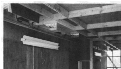
写真9 内部循環ファン
