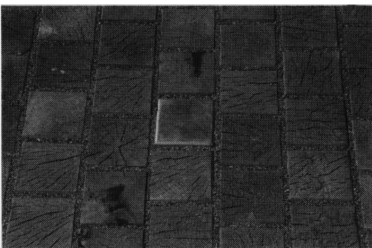
写真9 木レンガの木口割れ
