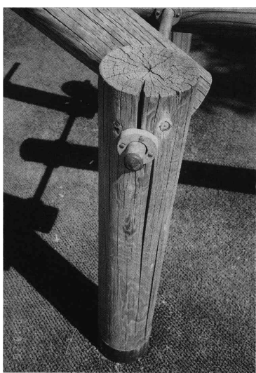
写真1 円柱材にみられた干割れ(篠路公園)
