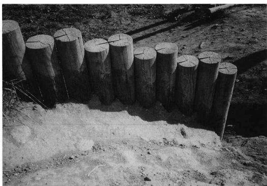
写真2 地際部分にみられた腐朽(精進河畔公園)
