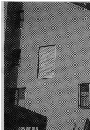
写真2 外付けシャッターの例 (PVCローラーブラインド)
