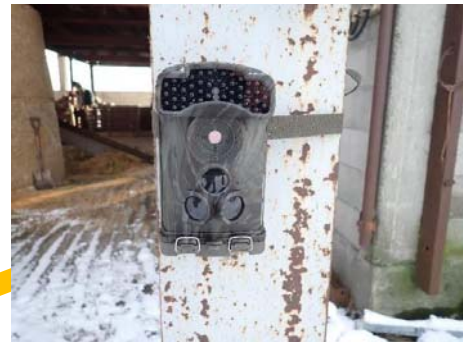
柱に自動撮影カメラを設置した例
