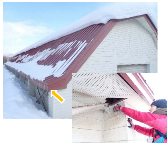
外壁の柱と天井の接合部に開いた穴
