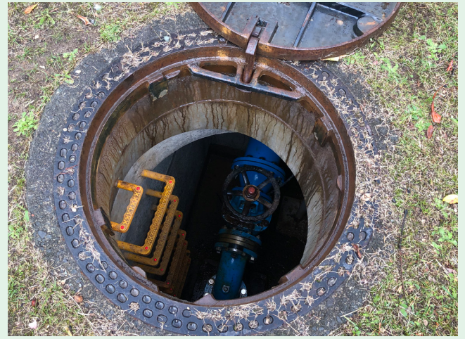
地域の水道を支える水道水源井戸
