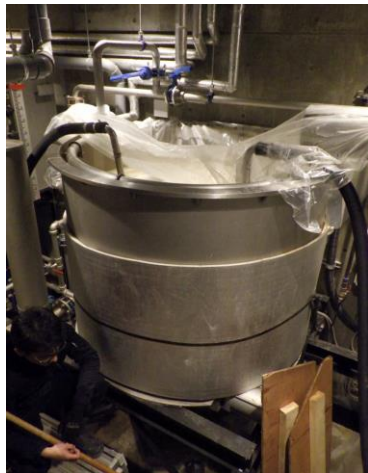
蛇管を入れた糖化槽
